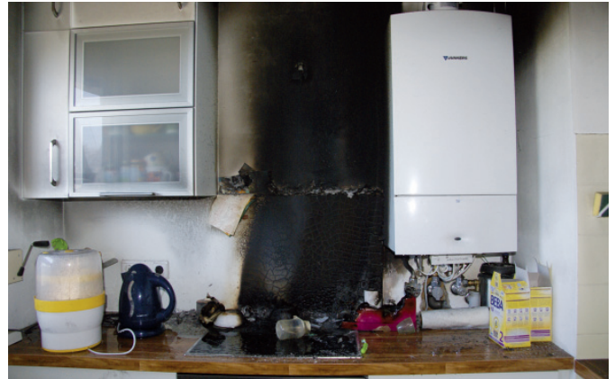
Das Vordringen zu diesem Küchenbrand wurde durch eine versperrte Wohnungstür erschwert. Die Tür musste erst gewaltsam geöffnet werden. Der Brand war trotzdem rasch gelöscht.
